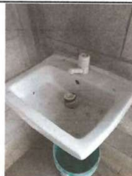
Foto 2: Sustrucción de accesorios y conexiones en lavamanos.
